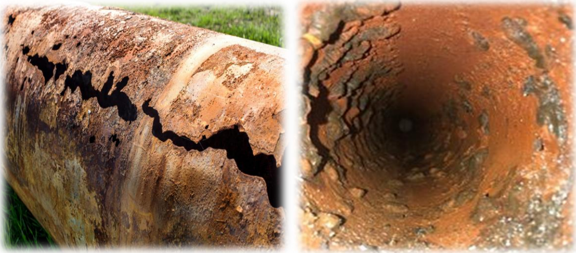
الشكل (1- 1): تأثير التآكل على خط انابيب النفط
